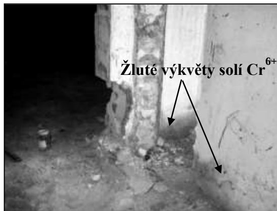
Obr. 7: Kontaminace Cr 6+ na zdech objektu
