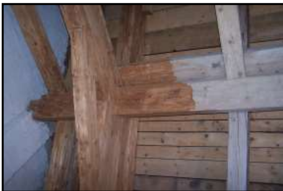
Obr. 1: Zřetelně viditelný rozdíl mezi zkušebně dekontaminovanými a ošetřenými trámy a neočištěnými trámy s bělavou povrchovou vrstvou na půdě barokního divadla
